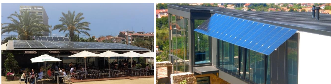
Figura 5: Instalación de paneles solares fotovoltaicos en un restaurante/cafetería. Fuente Diercol Solar 15 y Portosolar 16
