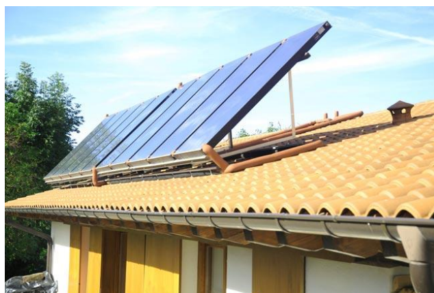
Figura 4: Instalación de colectores solares térmicos en un restaurante/cafetería. Fuente: Acimuth 13
